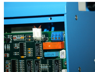
Das Potential-Relais befindet sich links-oben auf der Leiterplatte
